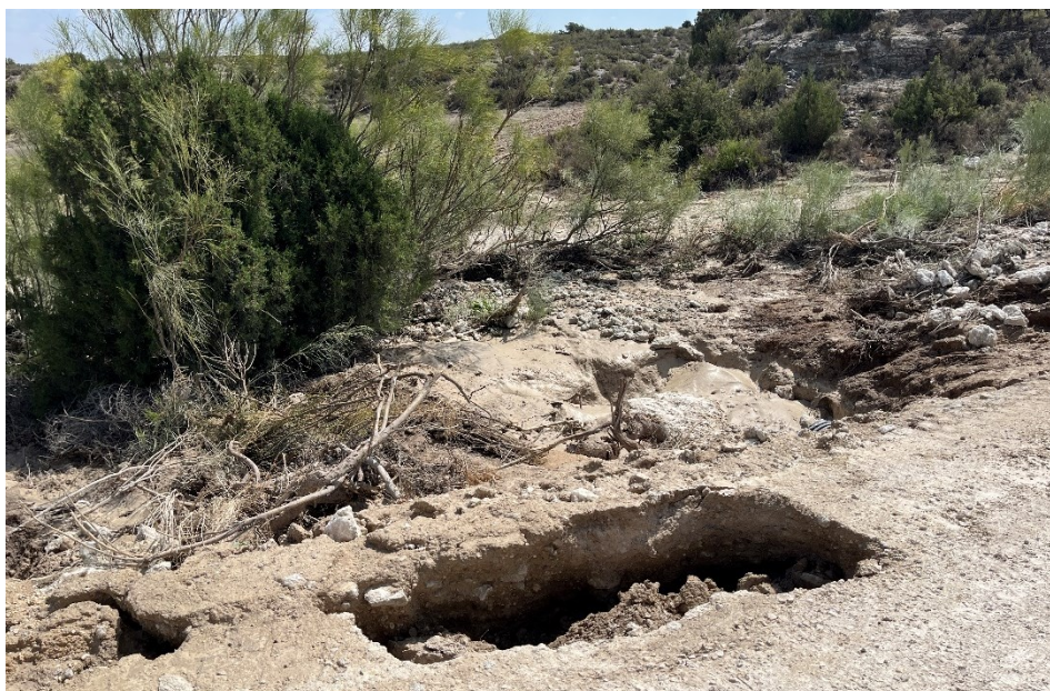
Figura 7 Afecciones del vial tras la tormenta
